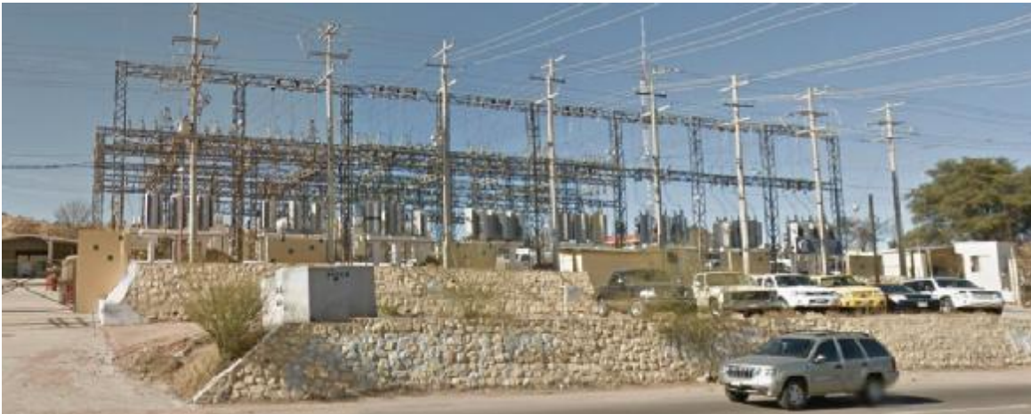
Figura 26. Subestación eléctrica CFE Nogales Industrial en el Blvd. Colosio
